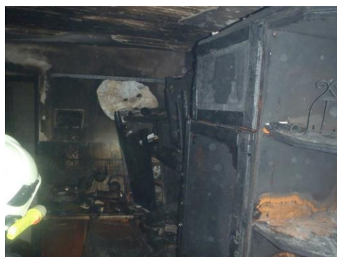
Unutrašnjost stana zahvaćenog požarom
