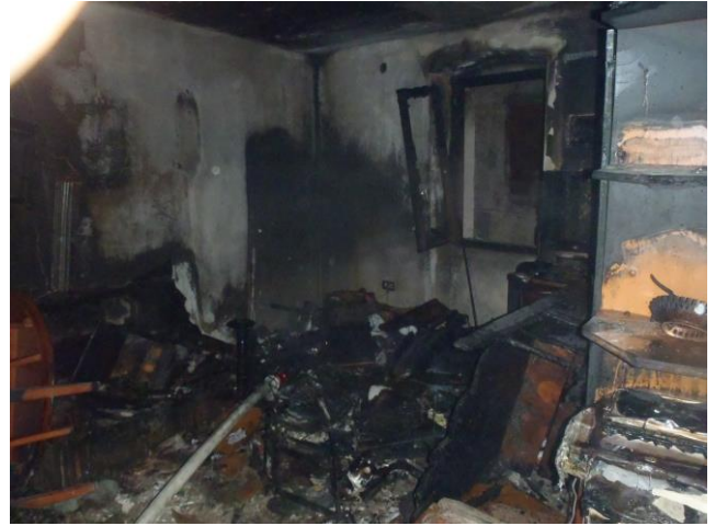
Unutrašnjost stana zahvaćenog požarom
